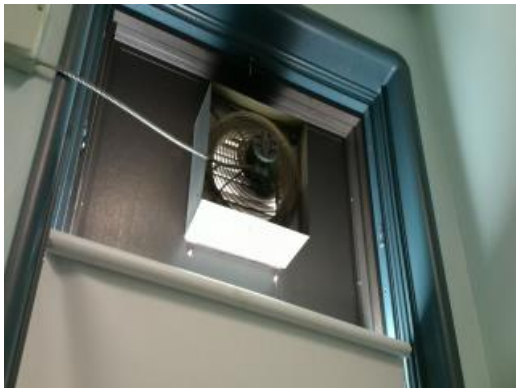
Wall Exhaust Fan
