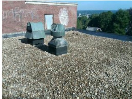
Small Exhaust Fan
