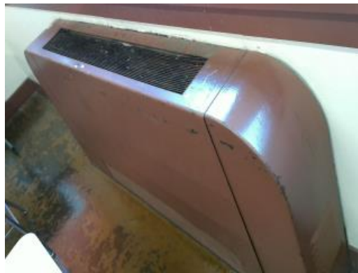
Original Fin Tube Heater
