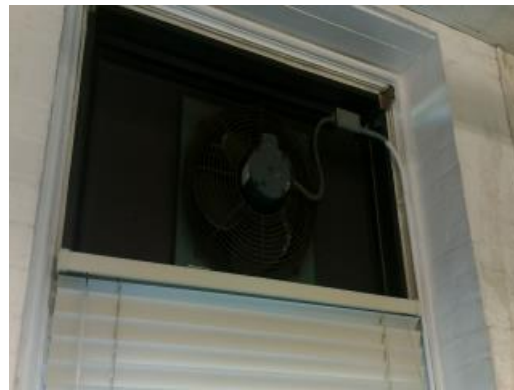
Wall Exhaust Fan
