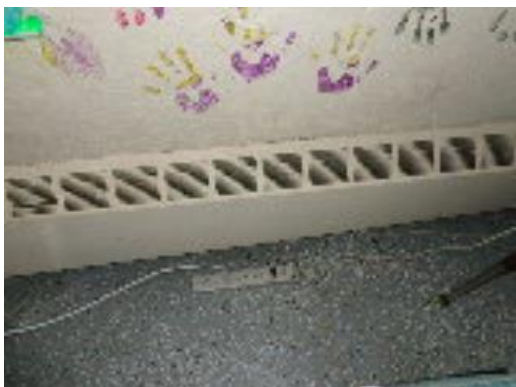
Fin Tube Radiators
