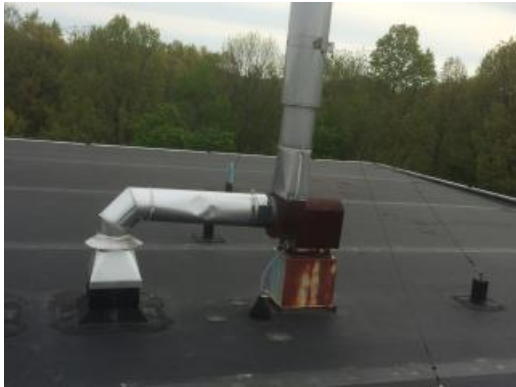
Fume Hood Exhaust Fan Stack
