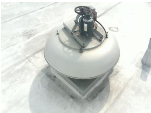
Exhaust Fan Missing Hood
