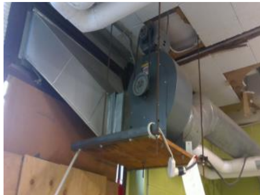
Wall Exhaust Fan
