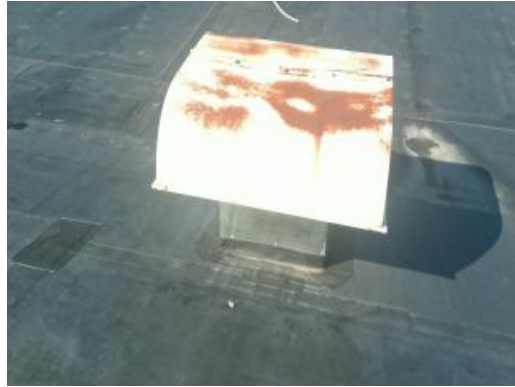
Weathered Exhaust Fan
