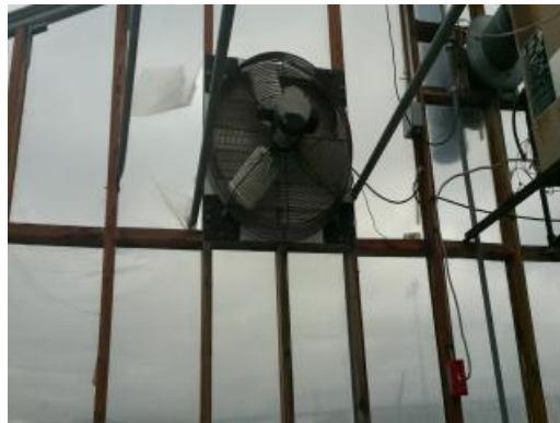
Wall Exhaust Fan
