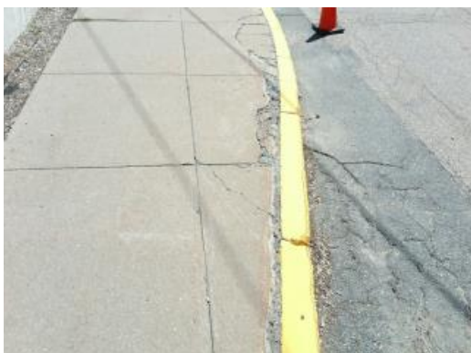
Sidewalk Edge Spalling
