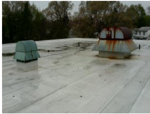
Rusted Exhaust Fan
