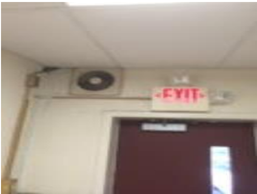
Wall Exhaust Fan
