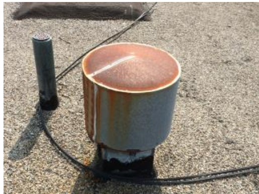
Rusted Exhaust Fan
