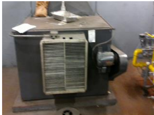
Boiler Exhaust Fan
