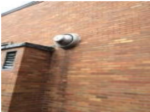
Inoperable Exhaust Fan
