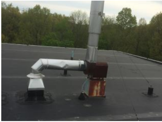
Fume Hood Exhaust Fan Stack
