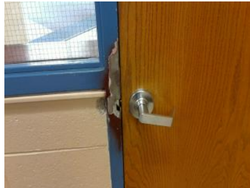
Worn Door Frame
