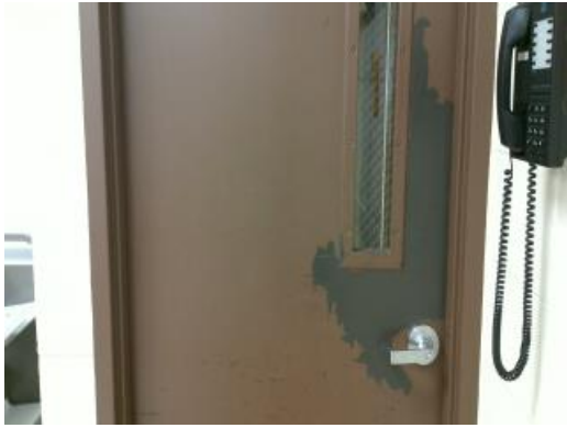
Peeling Paint On Door
